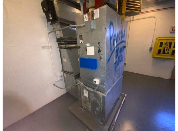
26 - FAN COIL UNIT
